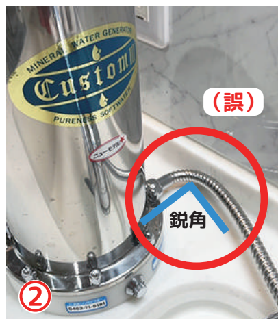
ジャバラホースが直角（鋭角）になっている
